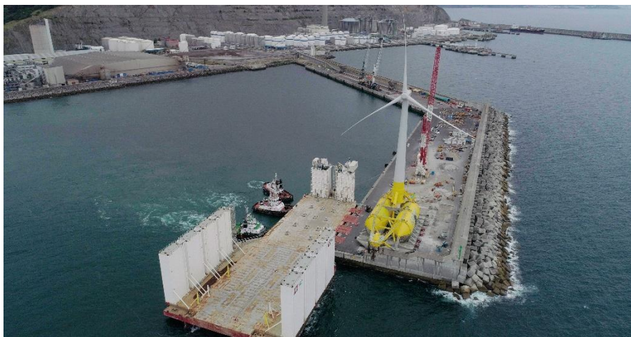
Operación de carga de DemoSATH
